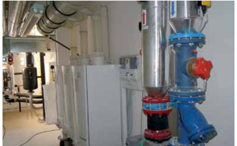
Kogeneracija- tukaj se proizvaja električna energija
